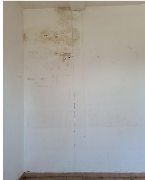
Slika 22. - Vertikalna pukotina - srednji zid
