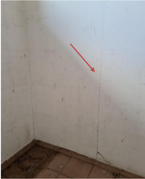
Slika 21. - Vertikalna pukotina - poprečni zid
