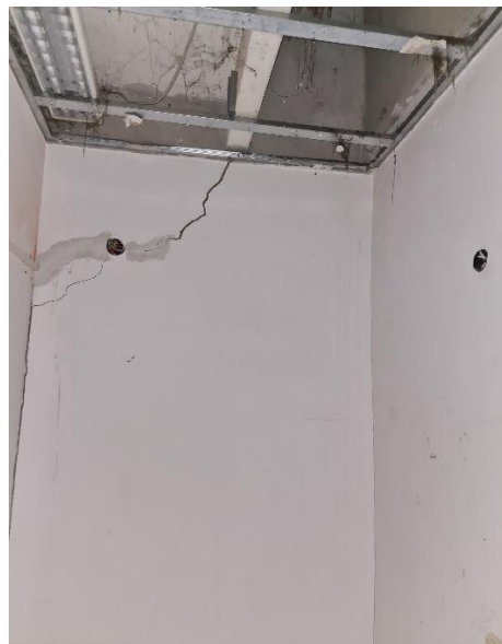
Slika 28. - Vertikalna pukotina - pregradni zid -spoj sa dijelom A
