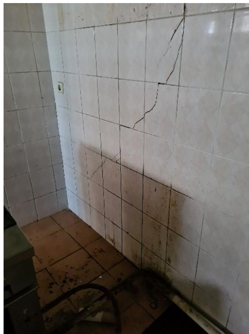
Slika 10. postojeće stanje - pregradni zid pukotina
