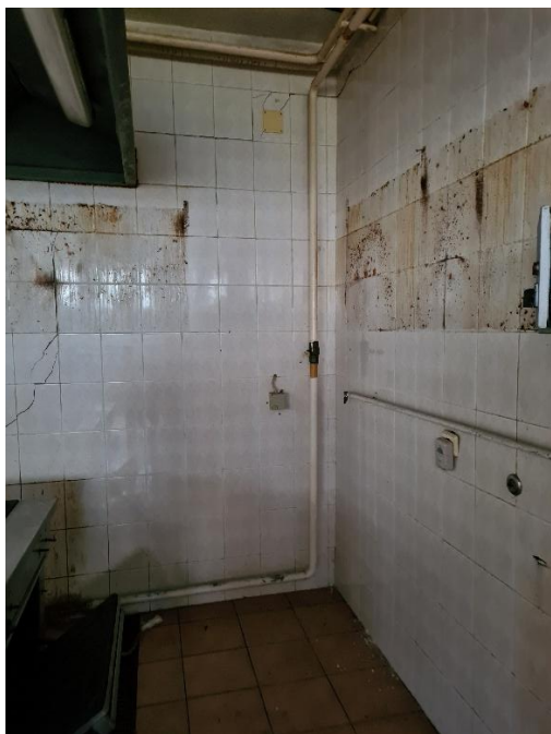
Slika 9. postojeće stanje - pregradni zid pukotina
