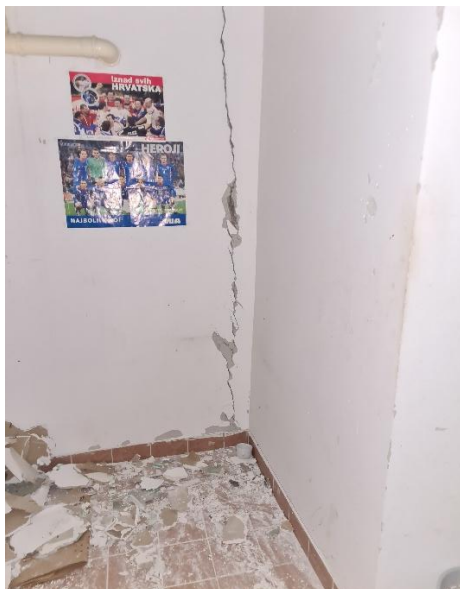
Slika 27. - Vertikalna pukotina - pregradni zid -spoj sa dijelom A
