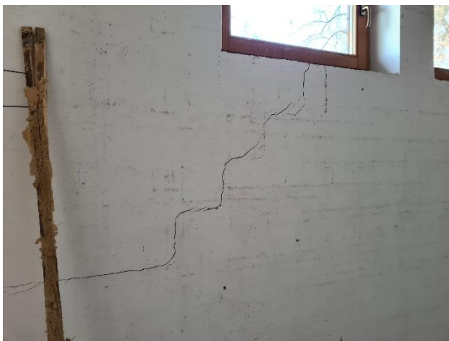
Slika 19. - Pukotine u vanjskom uzdužnom zidu
