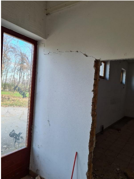
Slika 17. - Pukotine u zidu - spoj vanjskog uzdužnog zida i unutarnjeg
