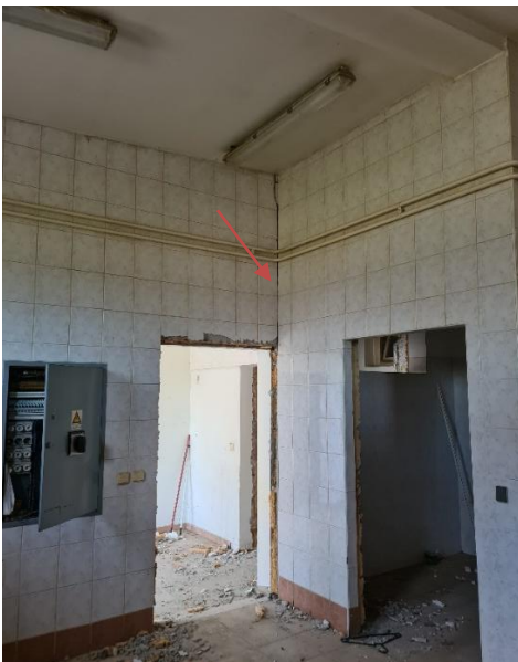
Slika 25. - Vertikalna pukotina na spoju zidova cijelom debljinom
