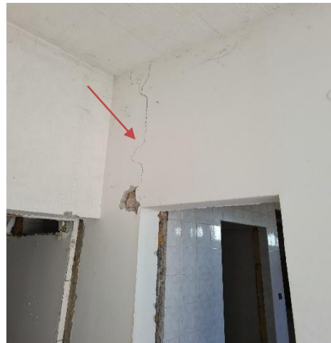
Slika 24. - Vertikalna pukotina - poprečni zid-ugao
