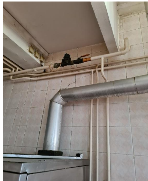
Slika 26. Vertikalna pukotina - pregradni zid - spoj sa dijelom A
