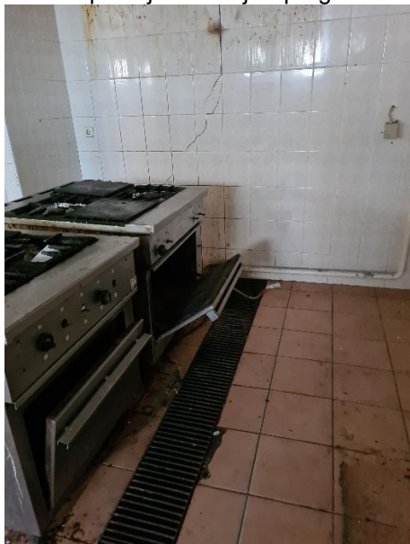
Slika 11. postojeće stanje - pregradni zid pukotina
