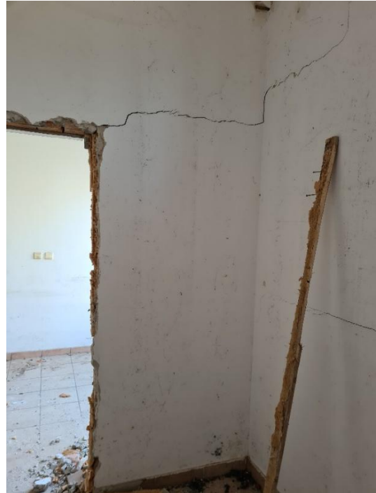
Slika 18. - Pukotine u zidu - spoj vanjskog uzdužnog zida i unutarnjeg
