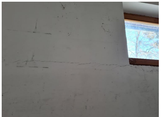
Slika 20. - Pukotine u vanjskom uzdužnom zidu
