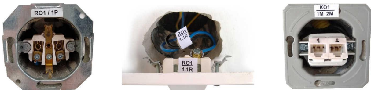
Slika 4.1-4 Označavanje priključnica jake, slabe struje i prekidača
