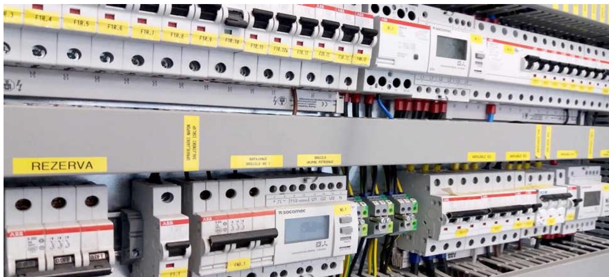
Slika 4.1-5 Označavanje uređaja unutar razvodnih ormara
