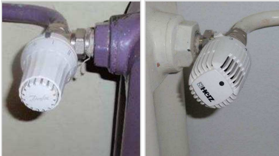
Slika 20: Termostatski ventili na radiatorima
