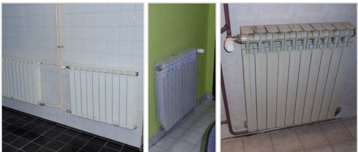
Slika 22: Radijatorska tijela u podrumu dvorane (svlačionice)
