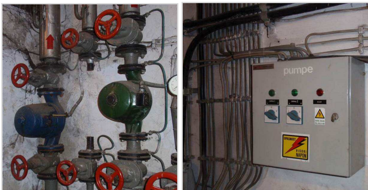
Slika 29: Razvod i cirkulacijske crpke u kotlovnici
