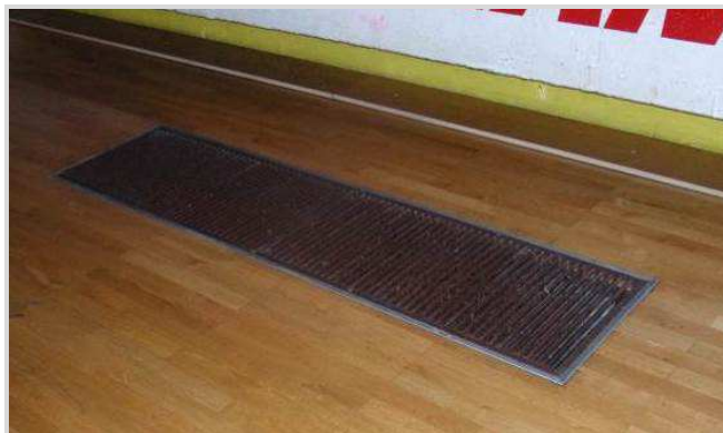
Slika 27: Podna rešetka sustava za toplozračno grijanje u dvorani
