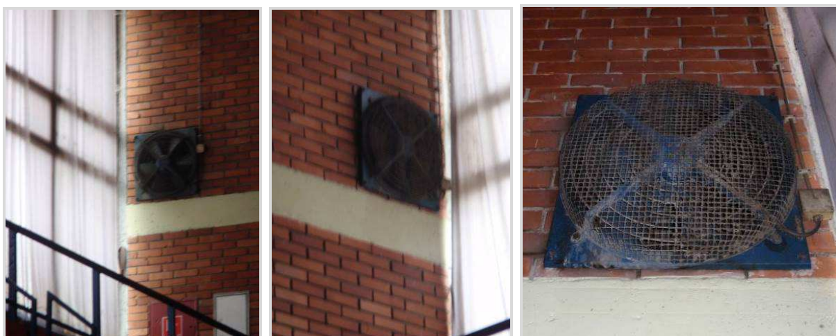
Slika 34: Ventilator za prozračivanje sportske dvorane
