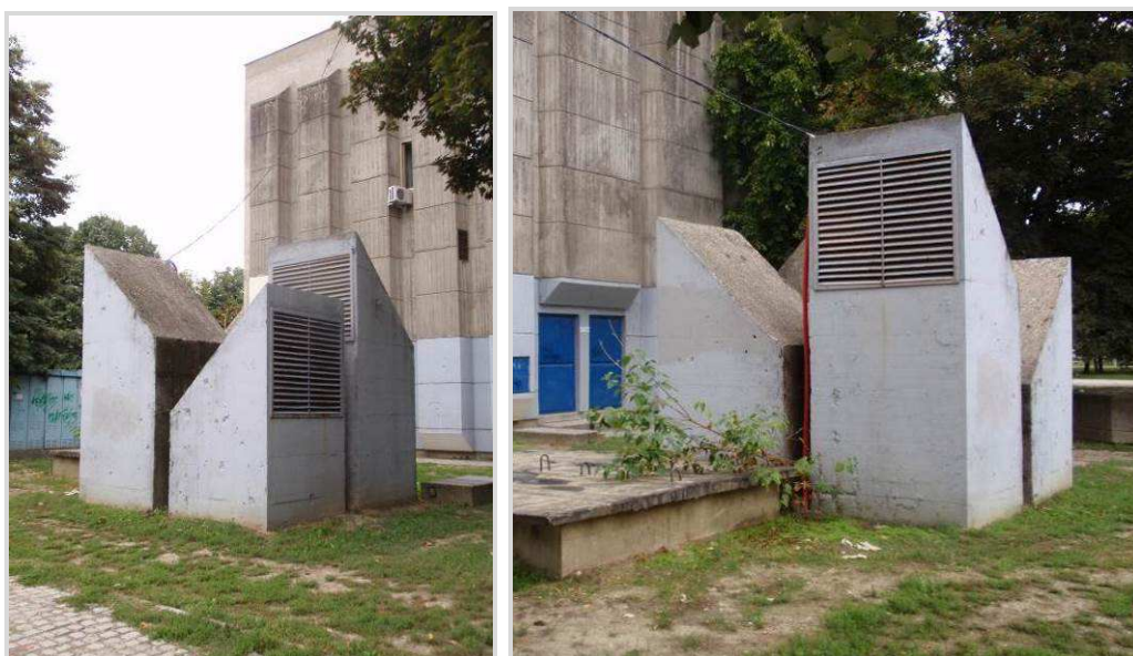
Slika 30: Otvori za zrak za toplozračno grijanje i prozračivanje
