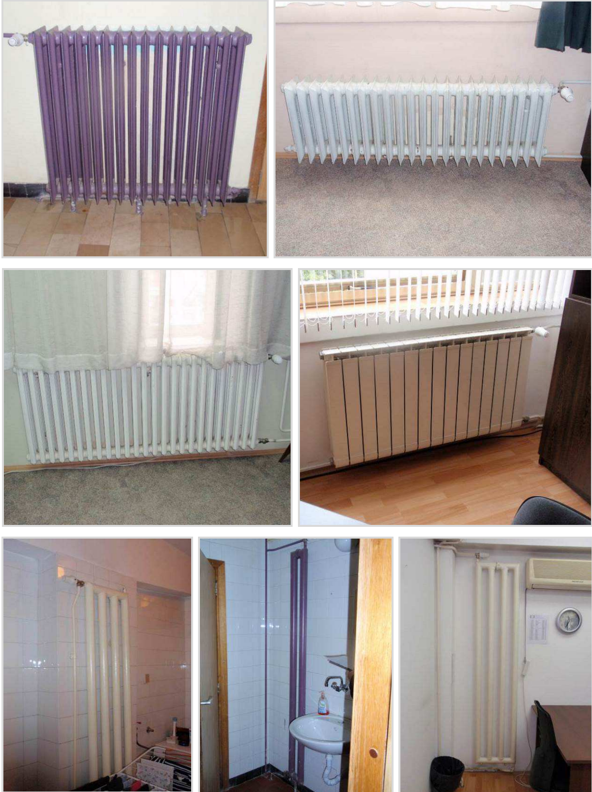
Slika 19: Ogrjevna tijela u sustavu centralnog grijanja uprave
